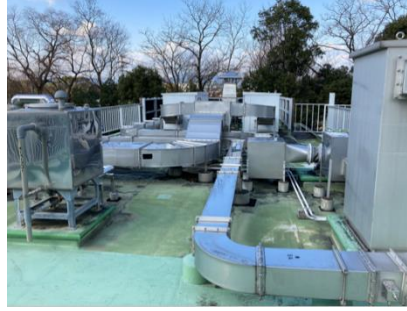
図2 屋上の排気ダクト
