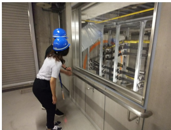
名城変電所から広がる地下ケーブル
